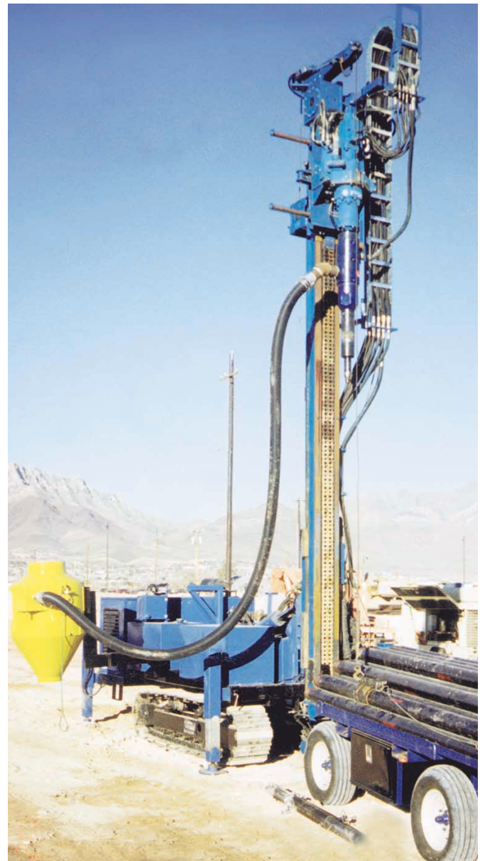
Geothermal drilling with discharge head and cyclone Geothermische Bohrungen mit Auswurfkopf (Preventer) und Zyklon
